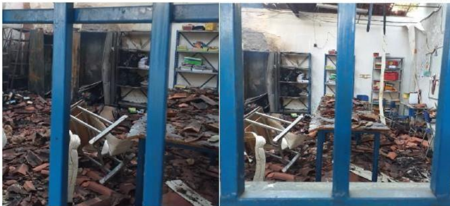
O local ficou destruído após o incêndio
